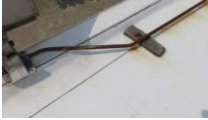
Rusted conduit on roof
